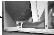
Spjället i vinterläge All tilluft passerar genom värmeåter- vinningen
